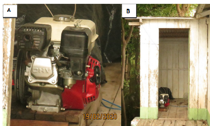
Figura 26. A e B. Gerador de Energia à diesel, 2020.
