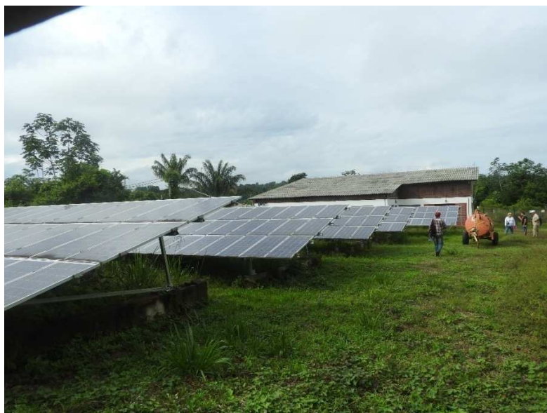
Figura 2. Sistema de energia fotovoltaico da vila de São Francisco do Iratapuru, Amapá. Foto: Vinícius Batista Campos (2015).
