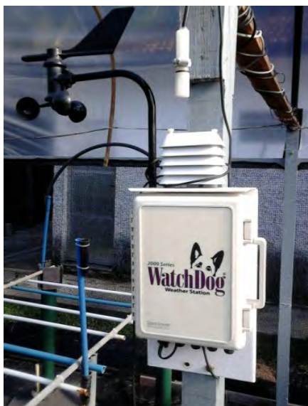
Figura 17. Estação meteorológica marca WatchDog 2000 instalada no ambiente interno.
