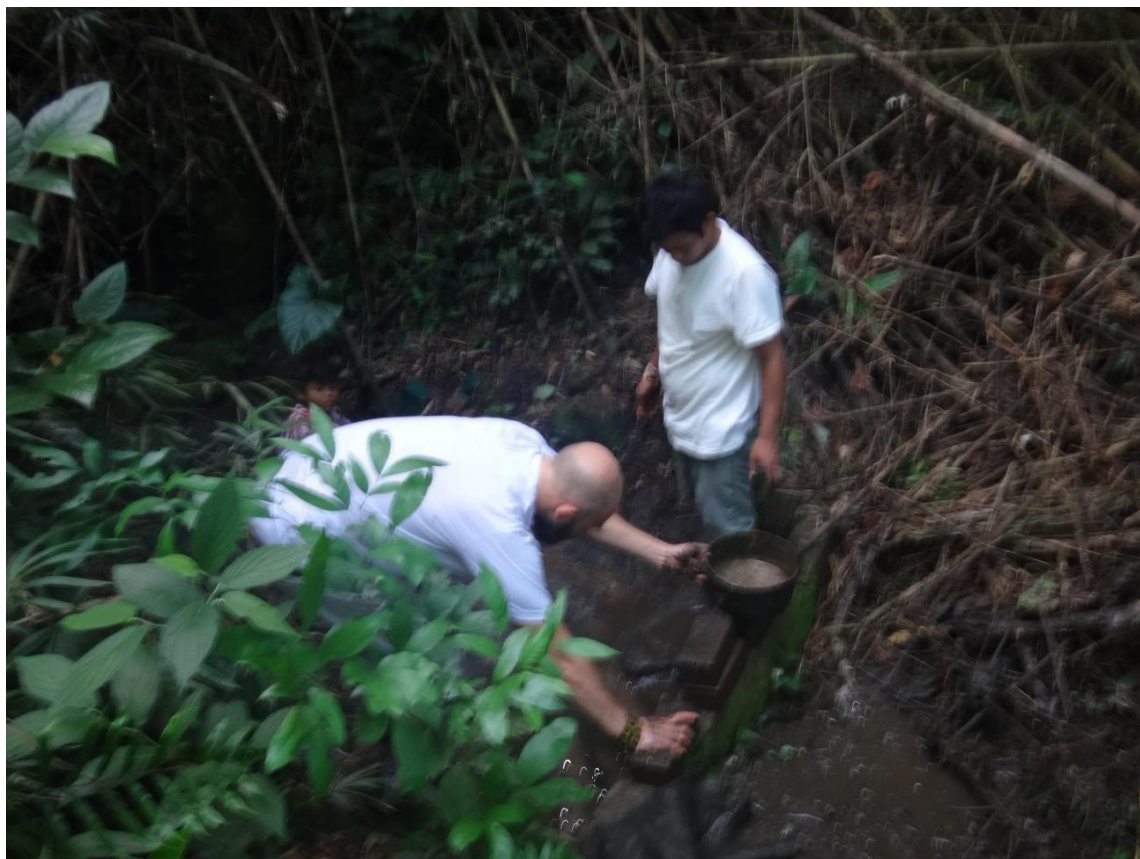
Figura 15: Neste calculamos a quantidade necessária de tijolos para aumentar a altura do reservatório. Tekoa Ará Rovy . (Foto: Emerson Gonçalves).
