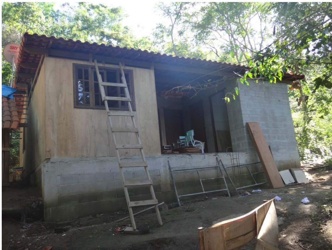
Figura 24: Construção da escola foi embargada pela direção do Parque Estadual Serra da Tiririca – RJ. E desde do meio do ano de 2016 nada mais foi avançado. Agosto de 2016. (Foto: Emerson Gonçalves).
