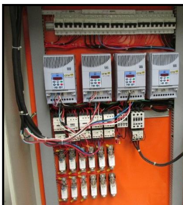
Figura 16. Inversores de frequência.
